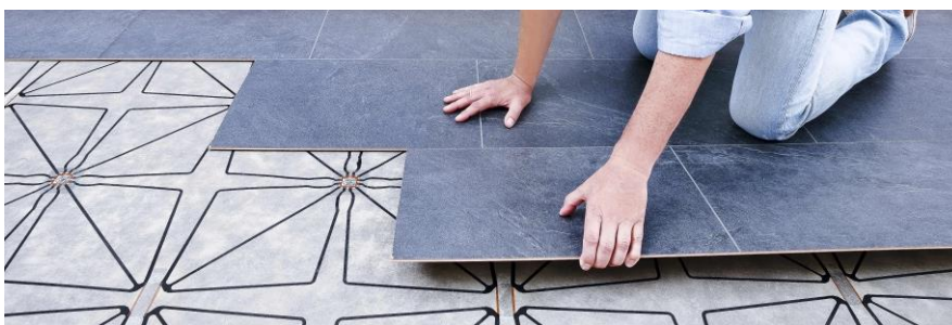
Abbildung 1: Unter dem Bodenbelag verlegter SensFloor. (Foto: FutureShape)
